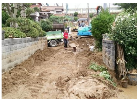
道路や家屋に流入した土砂
